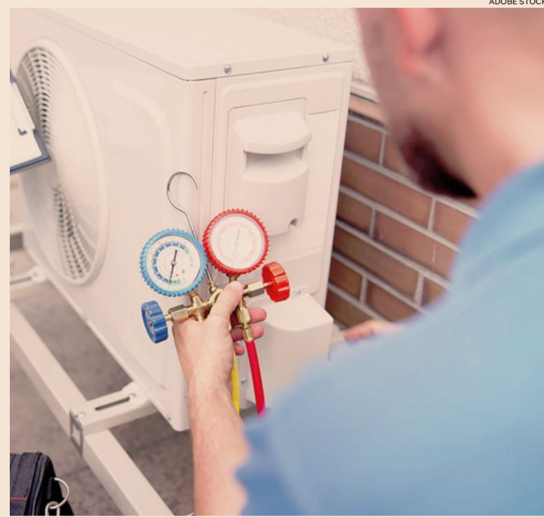
Cosa cambia. Le nuove norme prevedono un passaggio progressivo ai gas naturali
